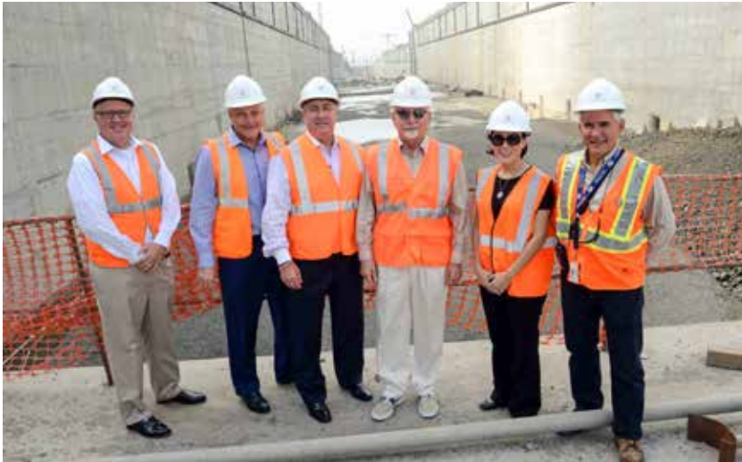
Jim Hertwig, presidente y CEO del FECR (tercero desde la izquierda), se reúne con funcionarios del Canal de Panamá y del Puerto de Miami en las obras de construcción de la ampliación.
