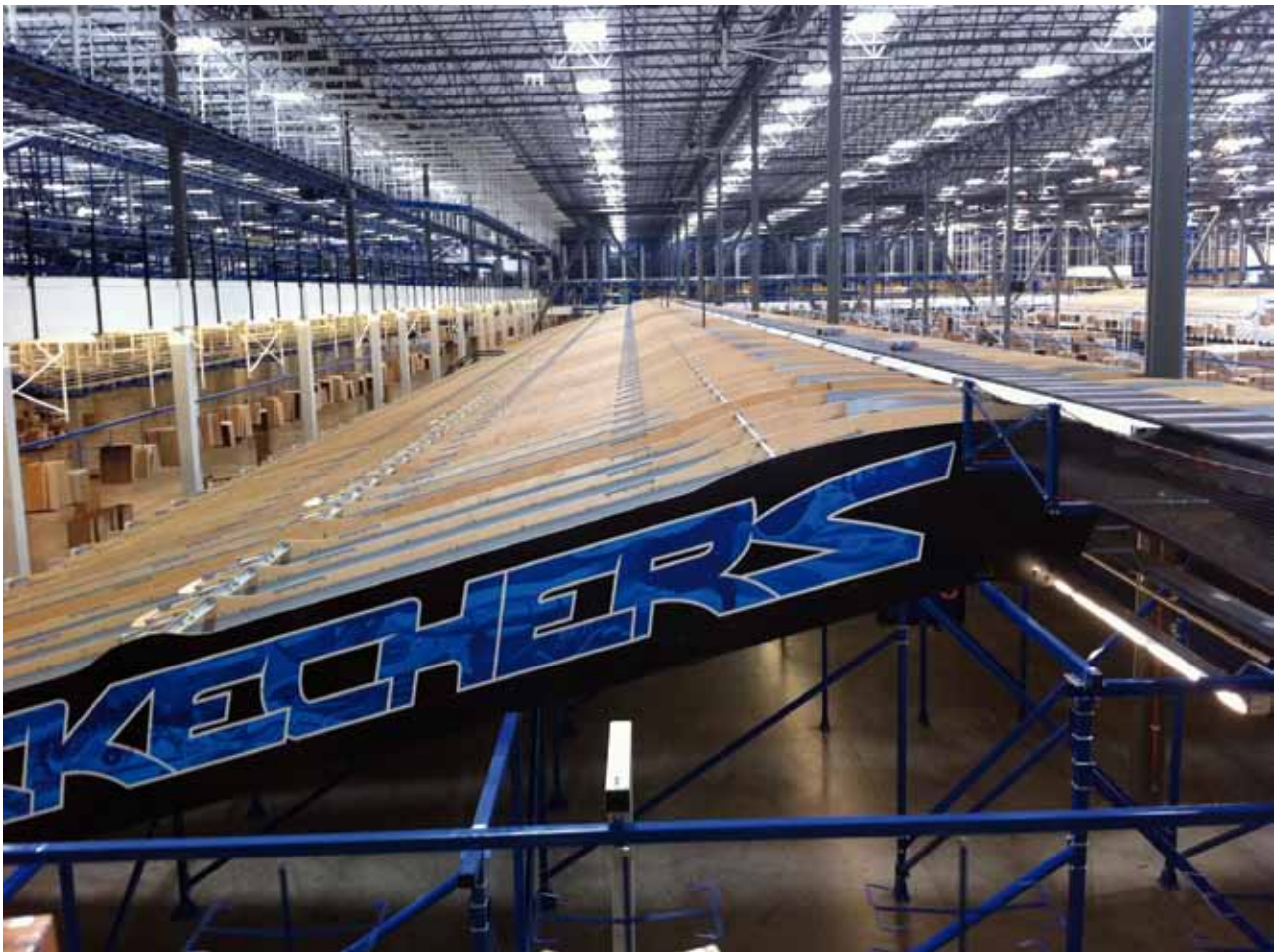
Skechers consolidó cinco CD en una instalación completamente automatizada, la cual ahora maneja tanto ventas al por menor como comercio electrónico.
